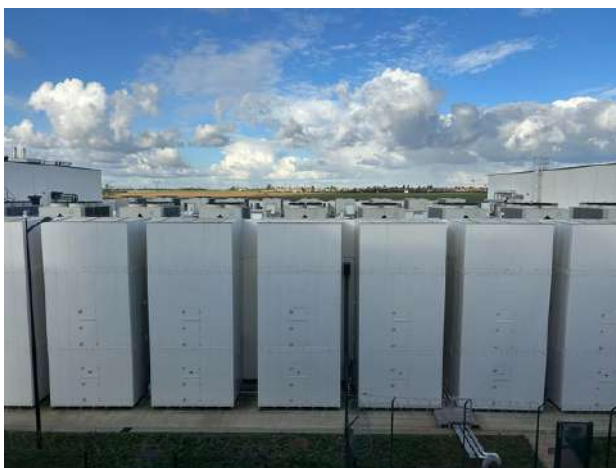
Visite du data center de Data4, 20 novembre 2025.
