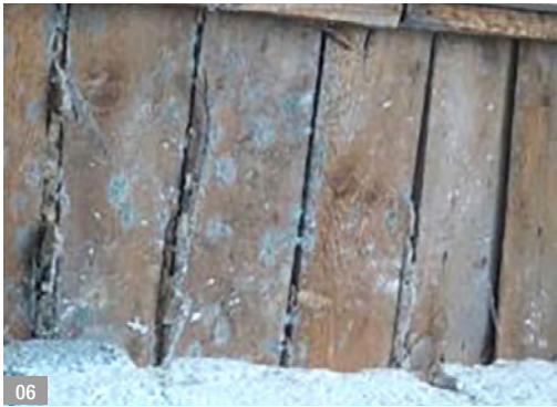
Abb. 04: Partieller Schimmelpilzbefall an der Unterseite einer Deckenschalung
