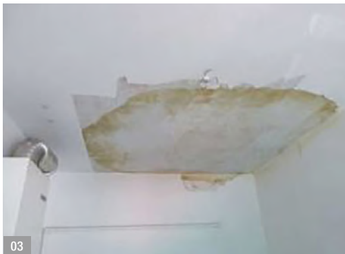
Abb. 01: Beschädigte Badezimmerdecke, Verfärbungen und Wasserablaufspuren
