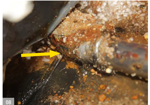
Abb. 08: Korrodiertes Fitting (vgl. Abb. 07), Detailsicht
