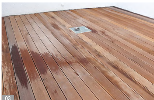
Abb. 03: Ansicht des beschädigten Holzbodenbelags, Lichthof 2
