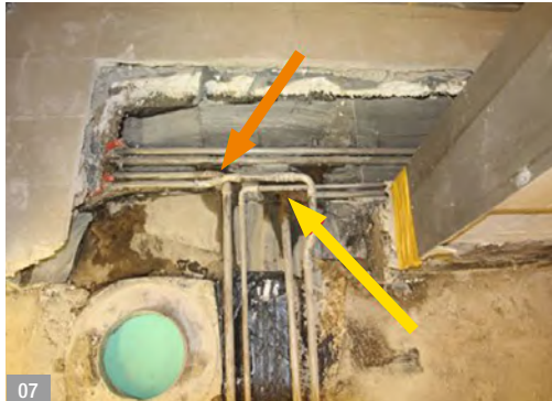
Abb. 07: Freigelegter Rohrleitungsabschnitt im Bereich der Kantine mit gekennzeichneten Wasseraustrittsstellen
