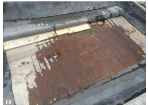
Abb. 08: Unterlaufene Notabdichtung, Blick auf die durchfeuchtete Deckenkonstruktion
