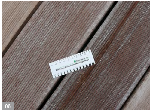
Abb. 06: Detailansicht der beschädigten Holzdielen
