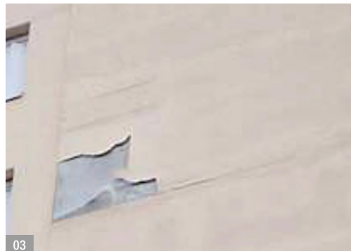
Abb. 03: Wassereintrag, Blasenbildung und großflächig abgeplatzter Putz durch eine nachlässige Vorbereitung des Untergrundes an den Betonierfugen. [Foto: AQC]
