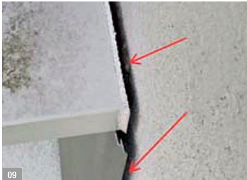
Abb. 09: Mangel bei der Abdichtung einer Dehnungsfuge. Seitens der Hersteller wird ein Spezialprodukt für diese besonderen Bereiche empfohlen [Foto: AQC]
