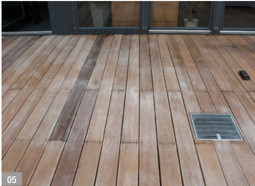
Abb. 05: Deutlich sichtbare Verfleckungen auf den Oberflächen der Holzdielen
