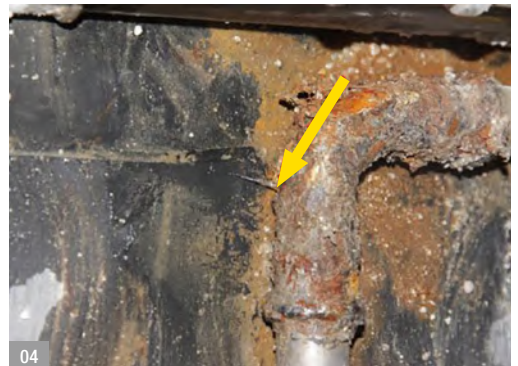
Abb. 04: Korrodiertes Fitting (vgl. Abb. 03) mit gekennzeichneter Wasseraustrittsstelle
