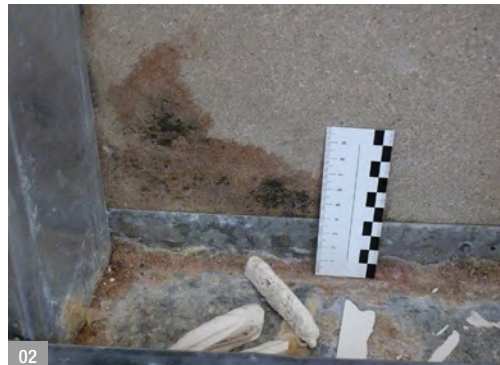
Abb. 02: Schimmelpilzbefall am Fußpunkt der Trockenbaukonstruktion
