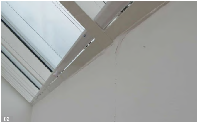
Abb. 02: Rissbildungen zwischen Glasdach- und Innenwandkonstruktion
