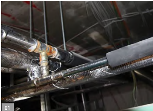
Abb. 01: Korrodiertes Fitting in einer Trinkwasserleitung in der abgehängten Decke im Bereich der Großküche
