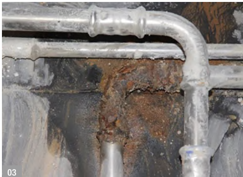
Abb. 03: Korrodiertes (Bogen-)Fitting in einer Trinkwasserleitung im Fußboden im Bereich der Großküche
