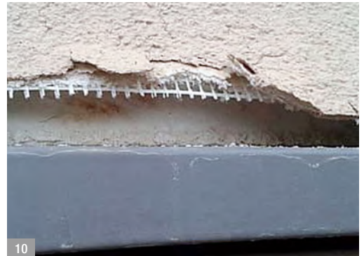
Abb. 10: Totalschaden am WDVS mit ausgewaschenem Grundputz [Foto: AQC]
