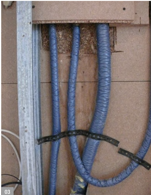
Abb. 03: Wasserablaufspuren an der Innenseite einer Trockenbauwand
