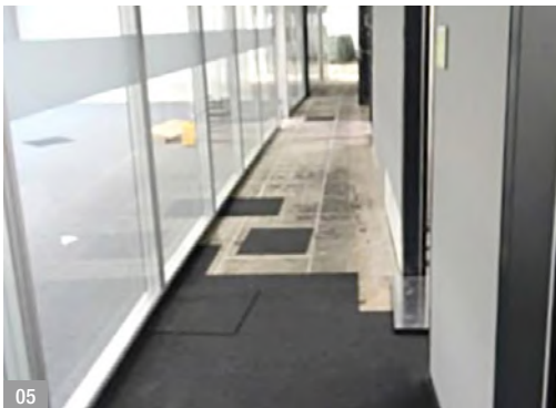
Abb. 05: Teilweise entfernte Teppichfliesen
