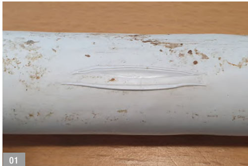
Abb. 01: In Längsrichtung gerissenes Mehrschichtverbundrohr. Das überdehnte Material ist an der Faltenbildung zu erkennen.
