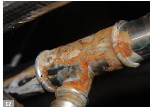
Abb. 02: Korrodiertes Fitting (vgl. Abb. 01)
