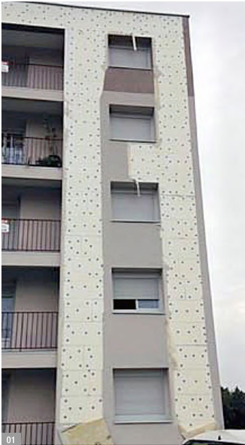
Abb. 01: Hier ist das WDVS wegen mangelnder Haftung des Grundputzes auf extrudiertem Polystyrolschaum (EPS vergilbt) heruntergerutscht. (Haltbarkeit/Lebensdauer des EPS nicht beachtet) [Foto: AQC]
