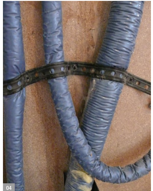
Abb. 04: Wasserablaufspuren und mikrobieller Befall
