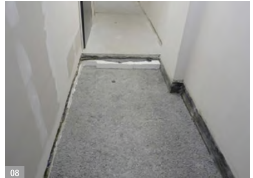
Abb. 08: Durchfeuchtete Fußbodenkonstruktion, teilweise entfernter Calciumsulfatestrich
