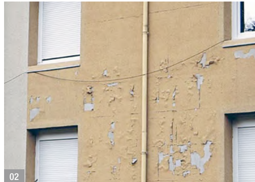
Abb. 02: Rissbildung, Wassereintrag, Abblättern von Putz und Farbe sowie Abplatzen des Anstrichs wegen einer zu starren Grundierung und einer geringen Auftragsstärke (Nichteinhaltung der Anwendungsempfehlung). Der Effekt wird durch den dunklen Anstrich noch verstärkt. [Foto: AQC]
