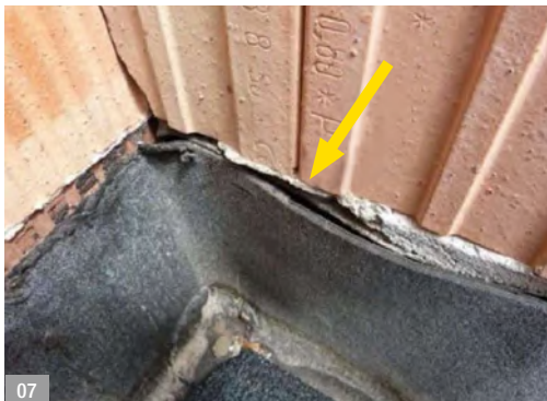
Abb. 07: Nicht regendichter Wandanschluss der Notabdichtung an einer aufgehenden Mauerwerkswand
