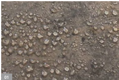
Abb. 01: Kondenswasser unter einer Betondecke im Bauprozess [Quelle: Bautrocknung matter]
