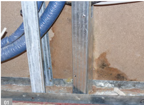
Abb. 01: Innenseite der Trockenbauwand mit Wasserablaufspuren und Schimmelpilzbefall
