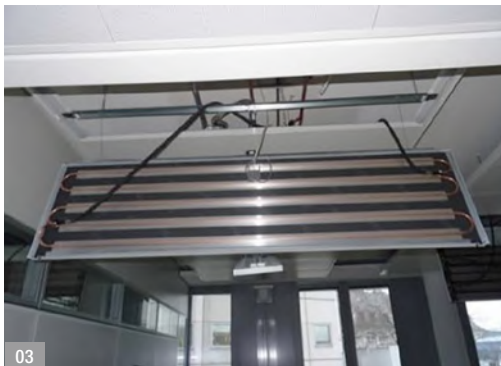
Abb. 03: Heruntergeklapptes Deckensegelement, Blick auf die integrierten Rohrleitungen und den Wasseranschluss Schlauch
