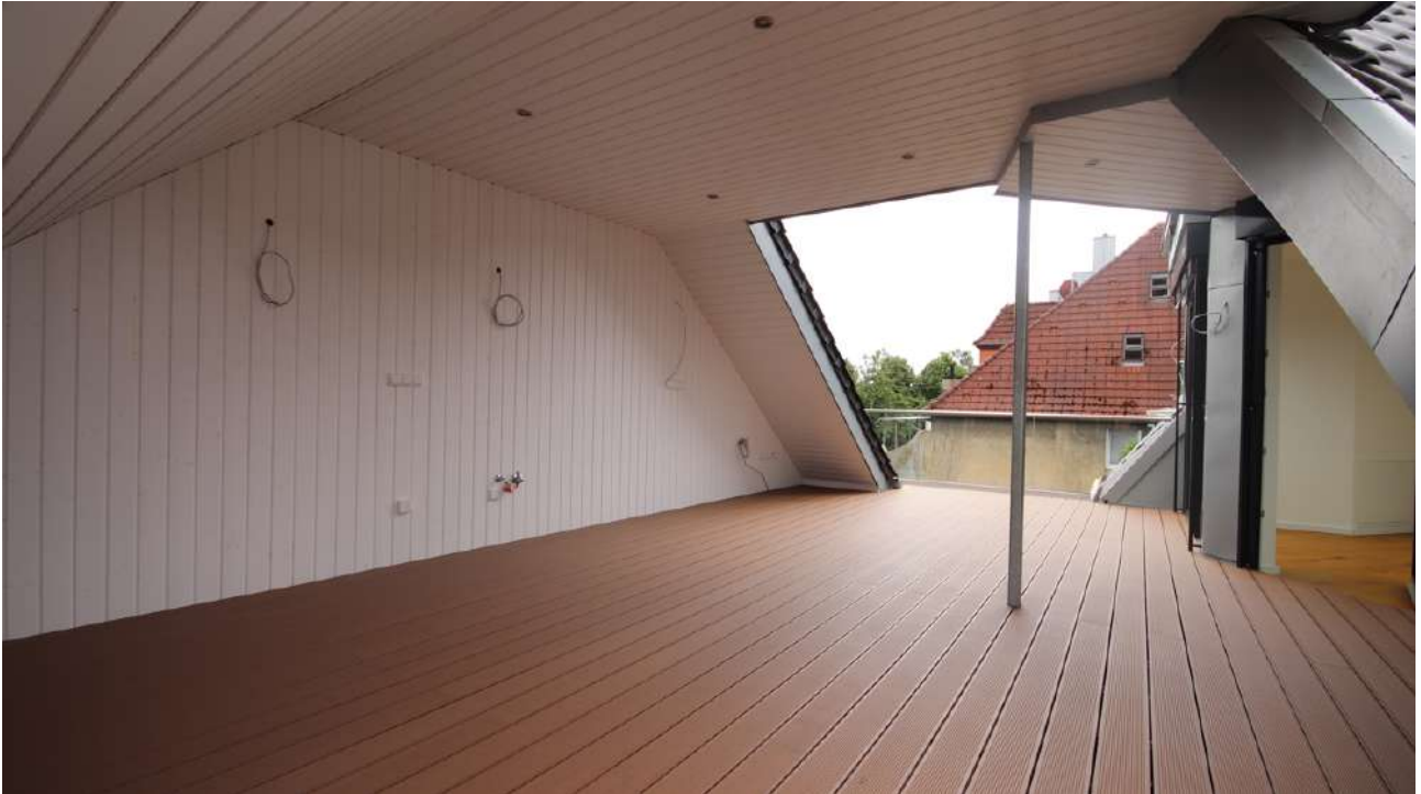
Dachterrasse - Anschlüsse Outdoorküche
