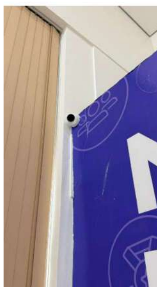
Figura 86 – Evidência de instalação de câmera de segurança na unidade Barreiras
