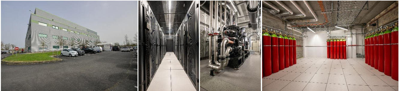
Photos du site X Edge Data Center de Bordeaux-Lac
