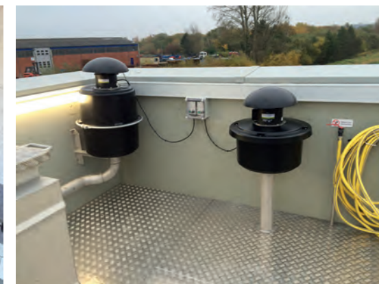
Rohrendfilter auf dem Dach installiert
