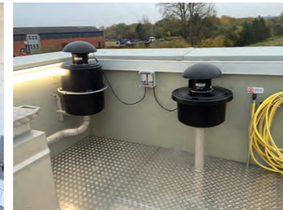
Rohrendfilter auf dem Dach installiert
