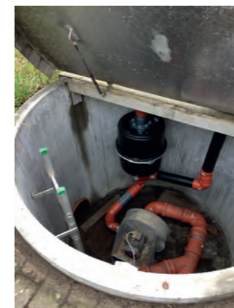
Filter platzsparend im Bauwerk eingebaut
