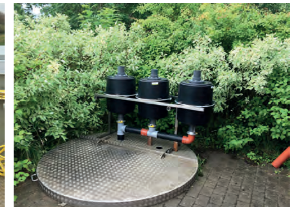
Dreifachfilter am Pumpwerk
