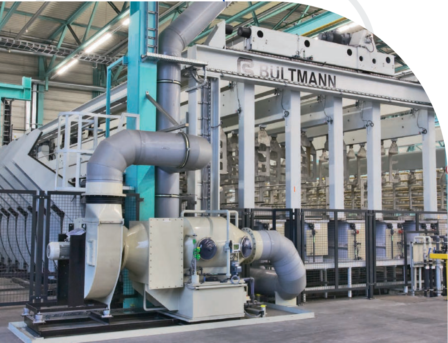
Beizanlage für Messingstangen Pickling equipment for brass bars
