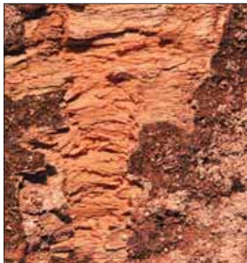
Von Weißfäule befallenes Holz.
