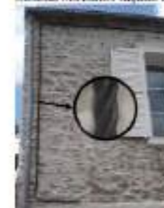
Reseau fils isolés façade BT
