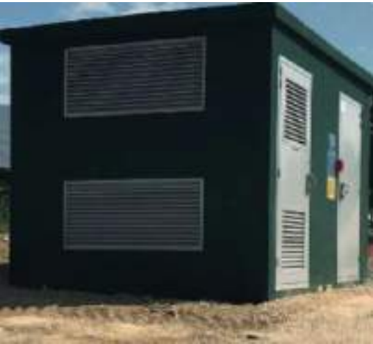
Figure 62. Exemple de local technique abritant le poste de transformation et le poste de livraison
