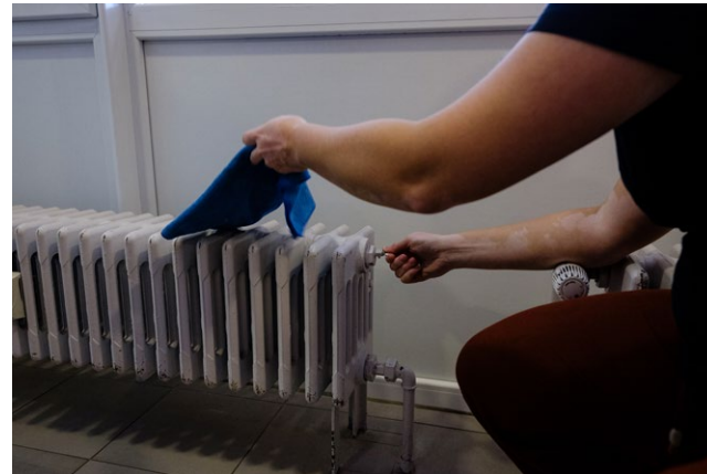
workshop chauffages ontlichten
