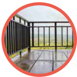
Garde-corps en métal
