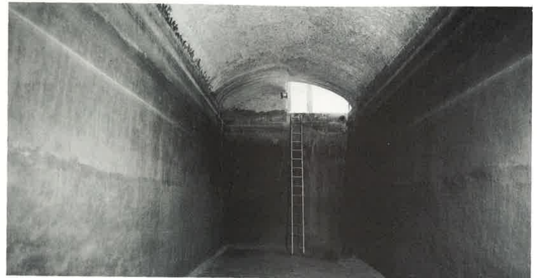
Als Vergleich eine Wasserkammer im neuen Reservoir 1981
