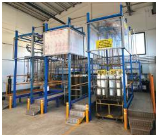
Станции заправки кислородом
