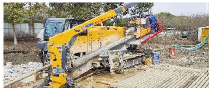
XZ2600E, \Phi 813\text{mm} , Power pipeline
