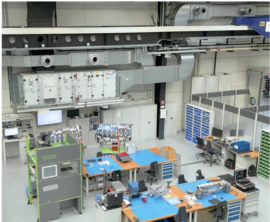
Konditioniertes Hallenklima für angenehmes Arbeitsklima.
