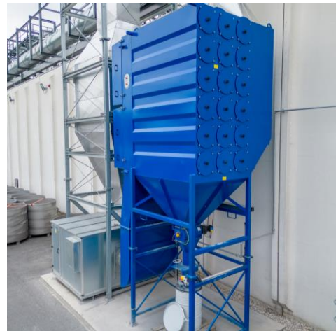
Abbildung 9: Die errichtete, wartungsarme Filteranlage
