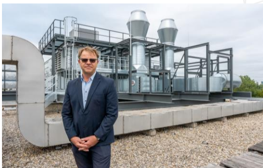
Abbildung 3: Technischer Leiter DI Gerhard Typelt vor der neuen Anlage
