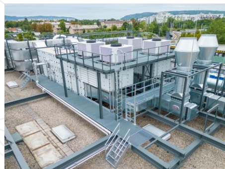
Abbildung 4: Die neue adiabate Kühlung am Dach von Kansai Helios
