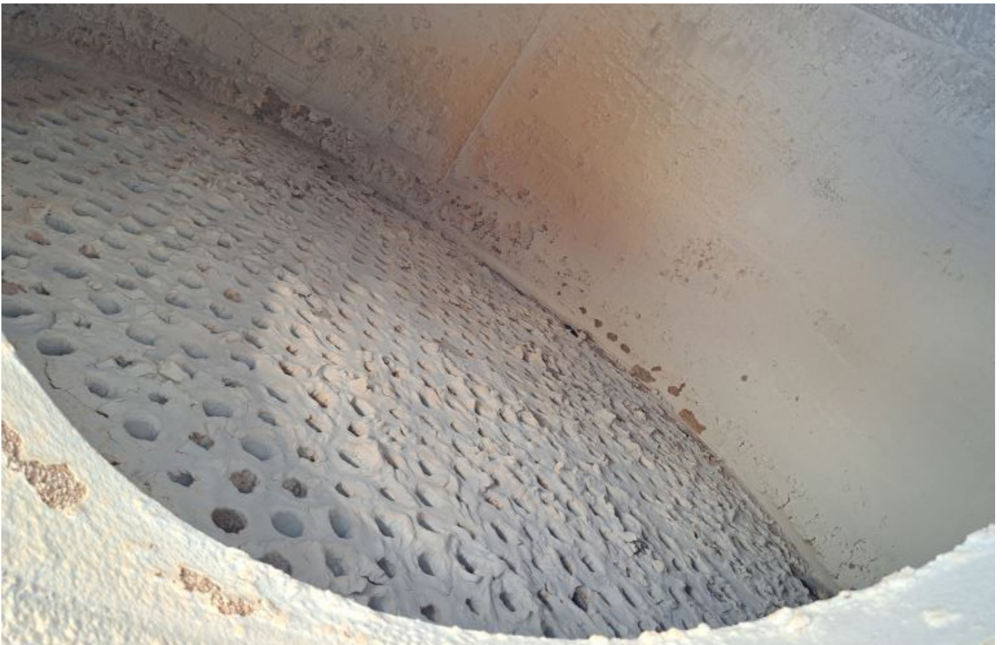
Bild 02: Der verunreinigte Wärmetauscher: Über die Jahre haben sich Ablagerungen gebildet, welche die Effizienz und Leistung beeinträchtigen. Eine umfassende Instandsetzung ist notwendig, um die Wärmerückgewinnung zu optimieren.
