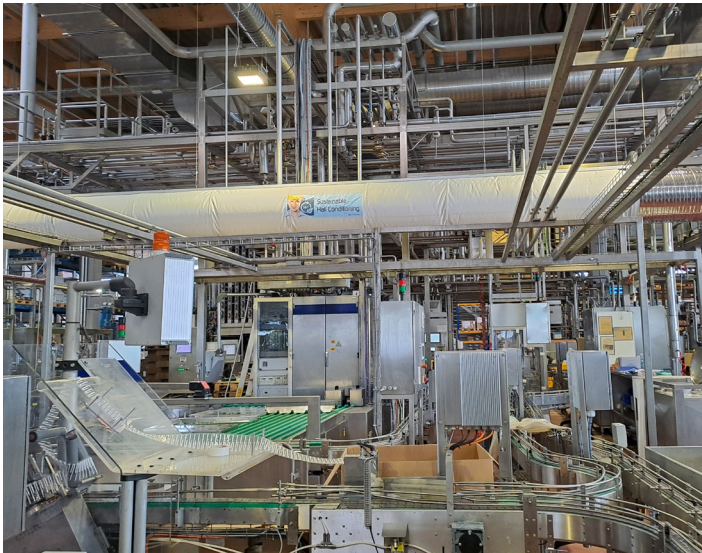
Bild 04: Das textile Zuluftschlauchsystem bewirkt eine zugfreie und gleichmäßige Verteilung konditionierter Luft
