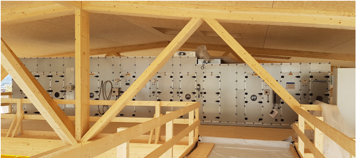
Bild 02: Lüftungsanlage (rechts) im Fachwerk des Schneidzentrums (Projekt 3)
