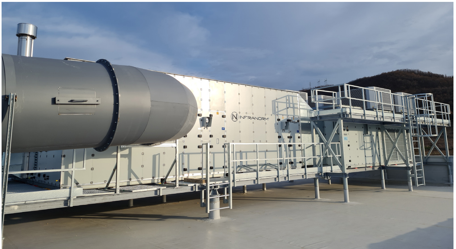
Bild 02: Außenaufgestellte Lüftungs- und Hallenkonditionierungsanlage mit integrierter Wärmerückgewinnung und Luftführung für die Schweißproduktion
