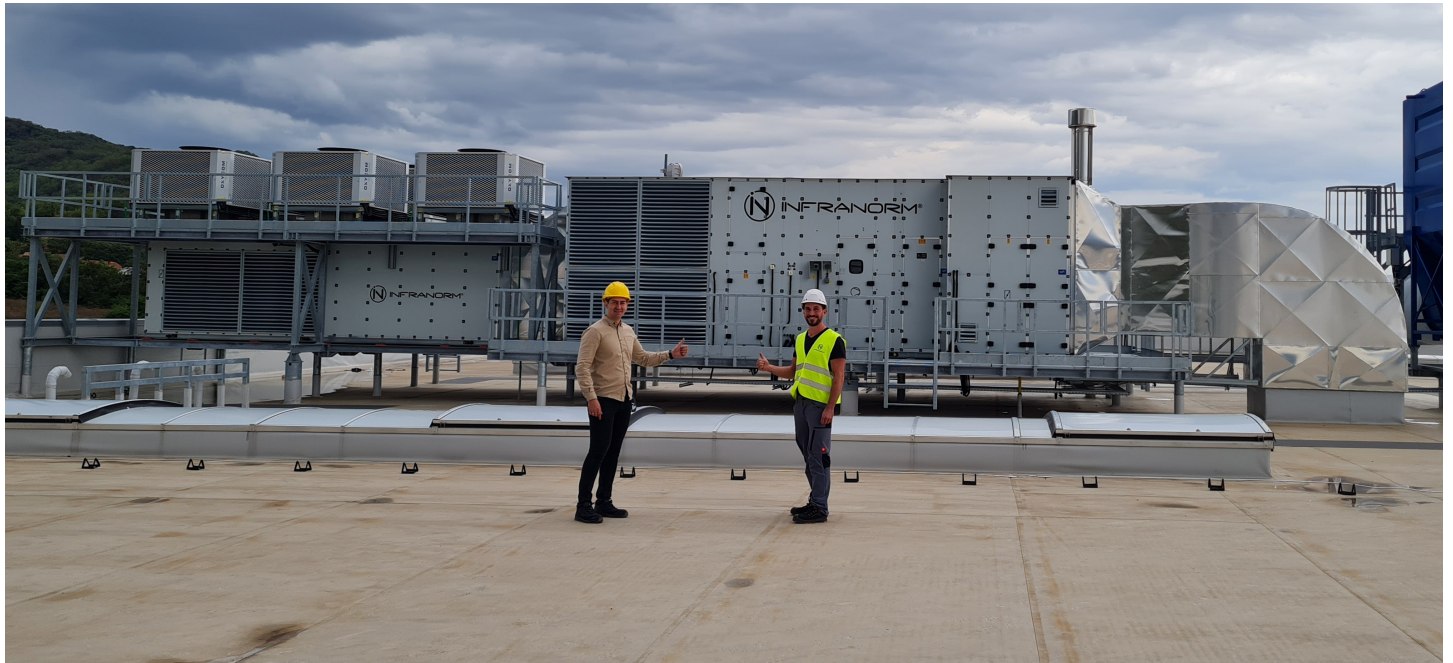
Bild 06: Dachaufgestellte SHC Anlage zur energieeffizienten Hallenkonditionierung der Schweißhalle
