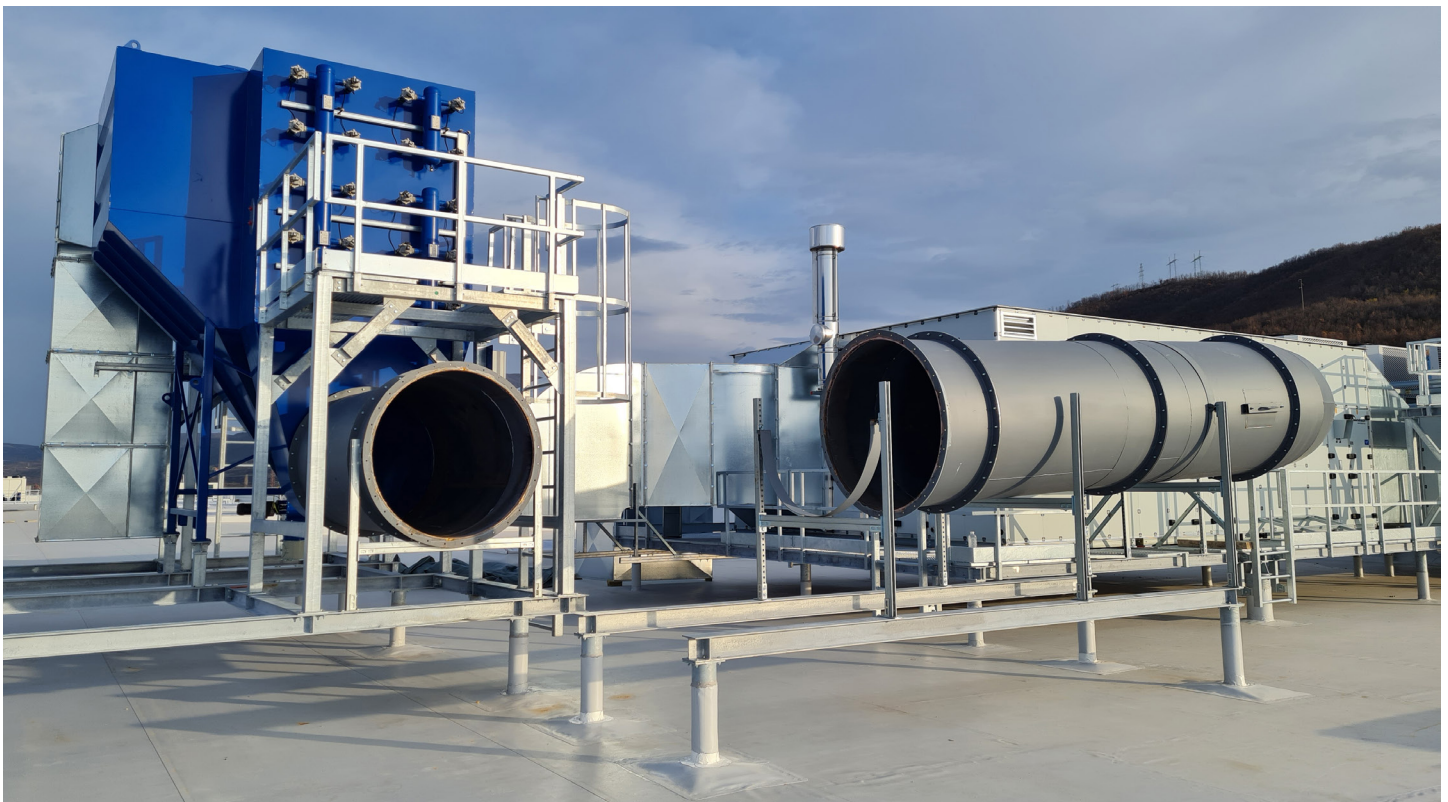
Bild 05: Patronenfilteranlage und Luftführungssystem zur Abscheidung von Schweiß- und Schleifemissionen in der Produktionshalle
