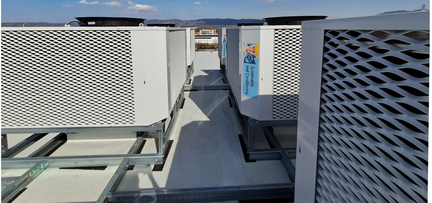
Bild 04: Dachaufgestelltes SHC-System zur energieeffizienten Hallenkühlung mittels zweistufiger adiabater Kühlung
