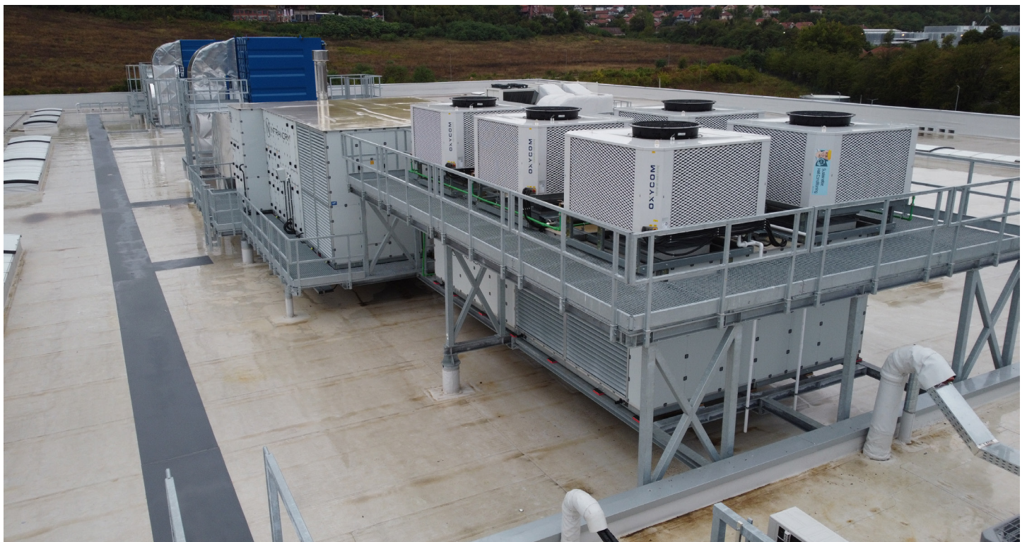
Bild 07: Dachinstallierte Rückkühler und SHC-Komponenten zur energieeffizienten Hallenkühlung
