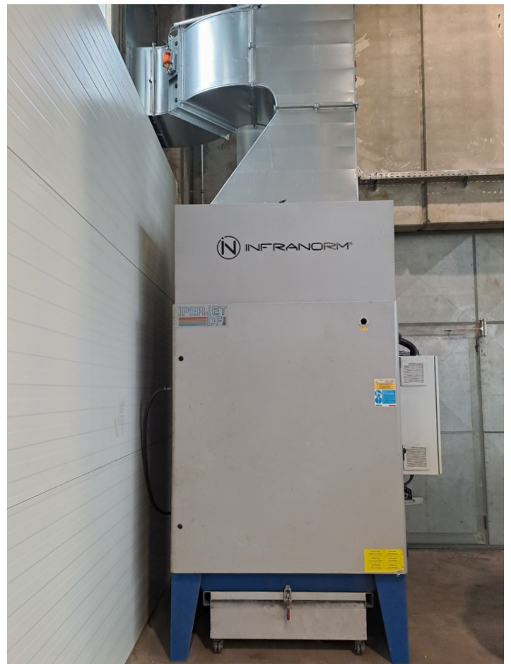
Bild 05: Bestehende Filteranlage, die im Zuge des Retrofits in das neue Gesamtsystem integriert wurde
