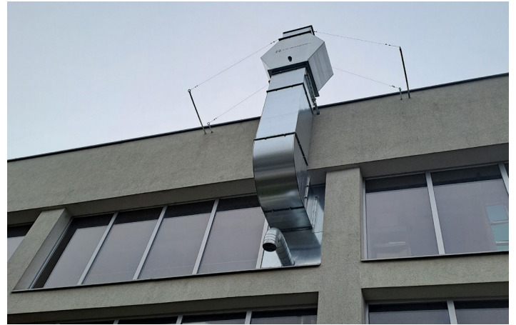
Bild 03: Außenliegende Fortluftführung der Hallenluftreinigungsanlage über Dach
