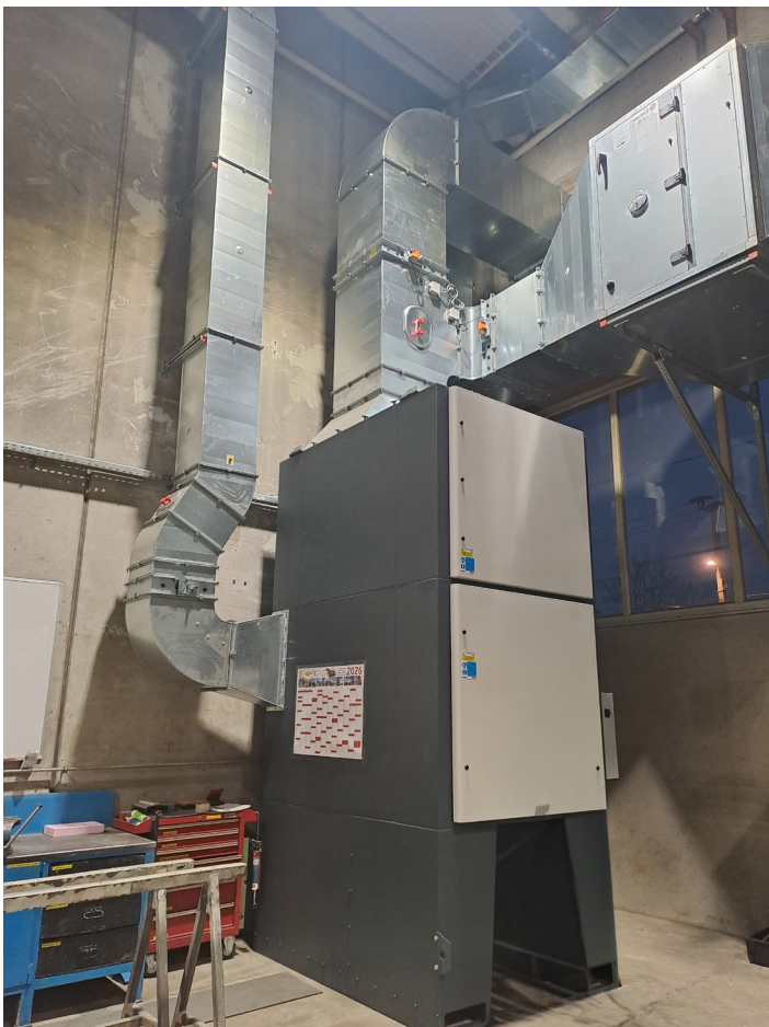
Bild 04: Neue Filteranlage mit angeschlossener Kanalführung für den Sommer- und Winterbetrieb
