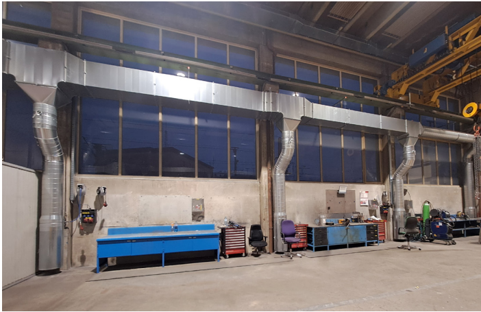
Bild 02: Zugfreie Zuluft einbringung in die Halle über Quellauslässe
