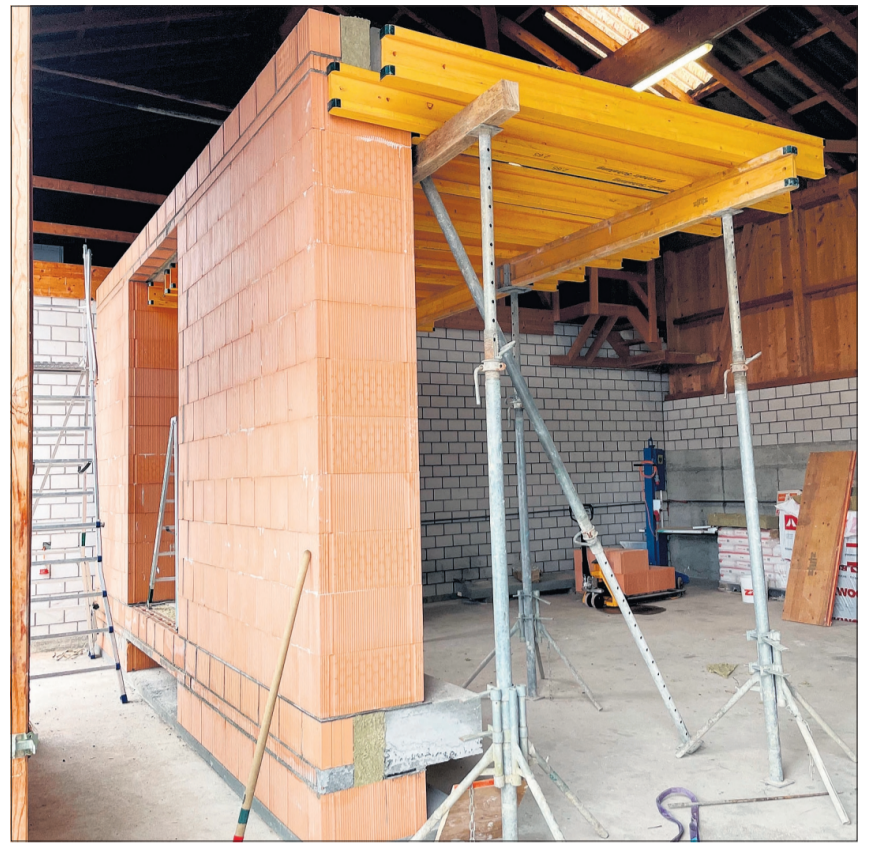
Vom Musterzimmer steht die Aussenmauer, die Decke ist in der Vorbereitung zum Betonieren. [Bild Sybille Weber]
