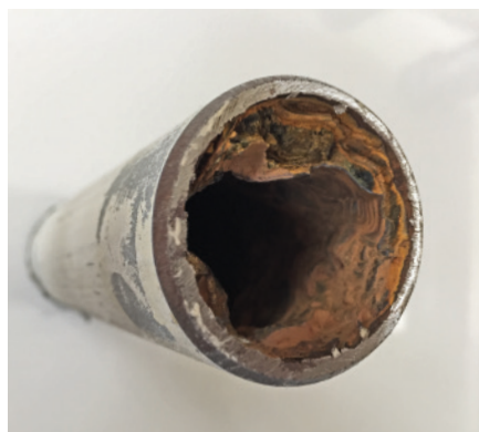
Tubo corrosivo e incrostato
