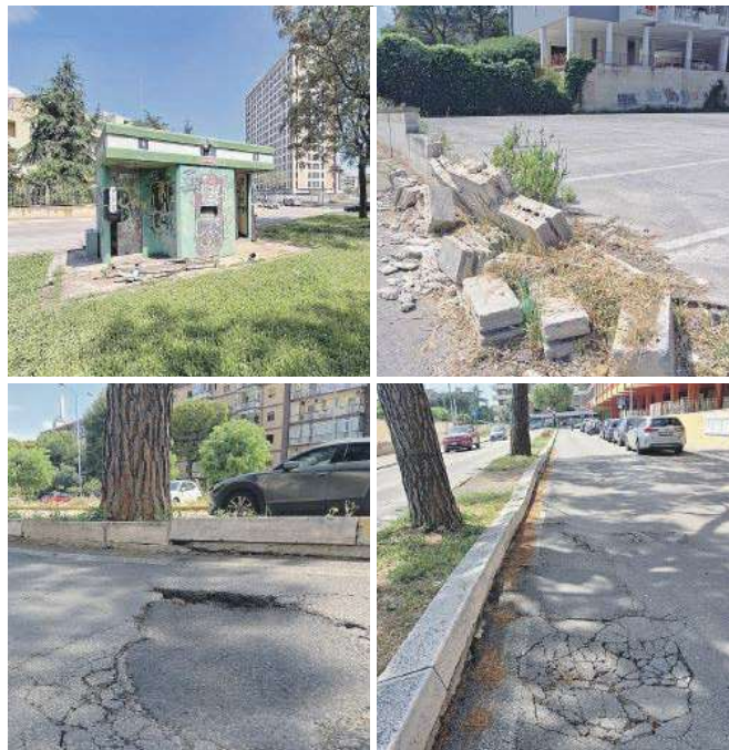
Le diverse situazioni di degrado urbano nel quartiere residenziale di «Poggiofranco» a due passi dagli uffici giudiziari penali del capoluogo pugliese
