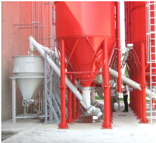
Rörtransportörer med skjutande drift, monterade under siloutlopp.
