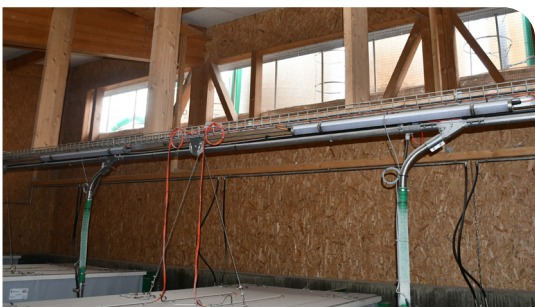
Des câbles propres et bien ordonnés facilitent le contrôle visuel des installations électriques. (Photo : SPAA)
