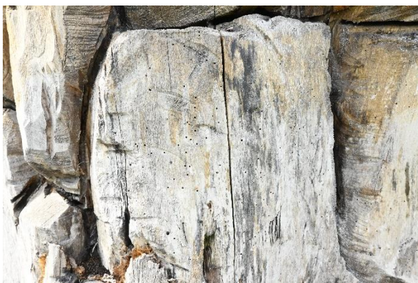
Obr. G5: Detail výletových otvorů od dřevokazného hmyzu ve východní části majáku ve výšce cca 20 cm nad terénem
