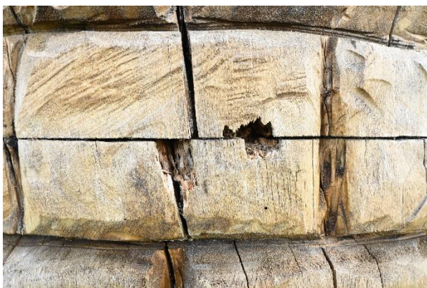
Obr. G8: Detail poškození způsobené houbou bílého tlení v severní části majáku ve výšce cca 235 cm nad terénem
