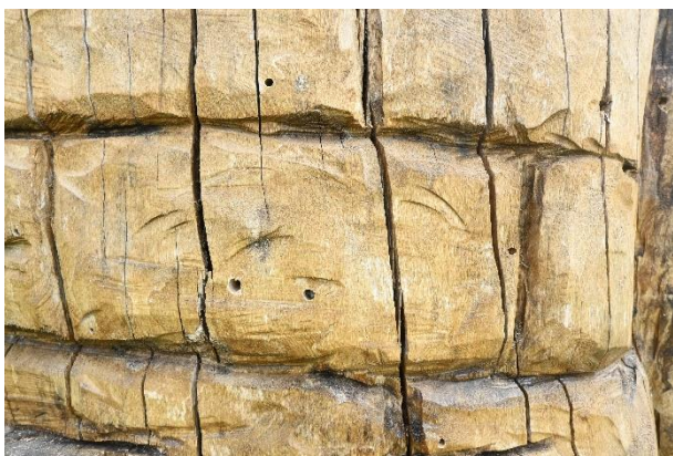
Obr. G11: Detail výletových otvorů od dřevokazného hmyzu v západní části majáku ve výšce cca 100 cm nad terénem
