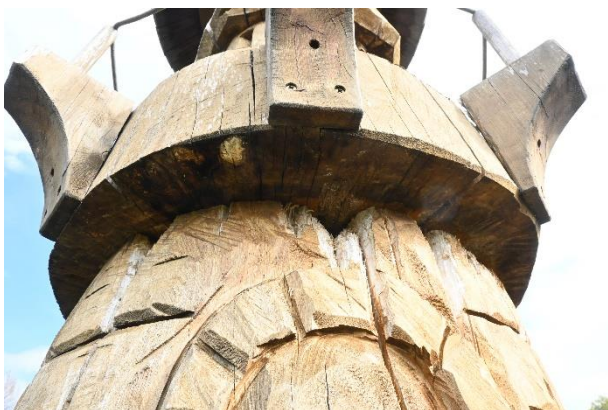
Obr. G12: Detail poškození způsobený činností ptactva při hledání aktivních larev dřevokazného hmyzu v západní části majáku ve výšce cca 440 cm nad terénem
