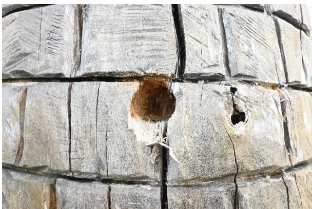
Obr. G9: Detail poškození způsobený činností ptactva při hledání aktivních larev dřevokazného hmyzu v severní části majáku ve výšce cca 380 cm nad terénem
