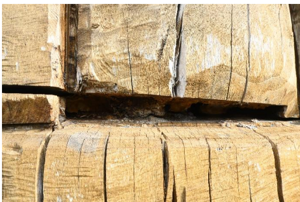
Obr. G3: Detail působení houby bílého tlení v jižní části majáku ve výšce cca 235 cm nad terénem
