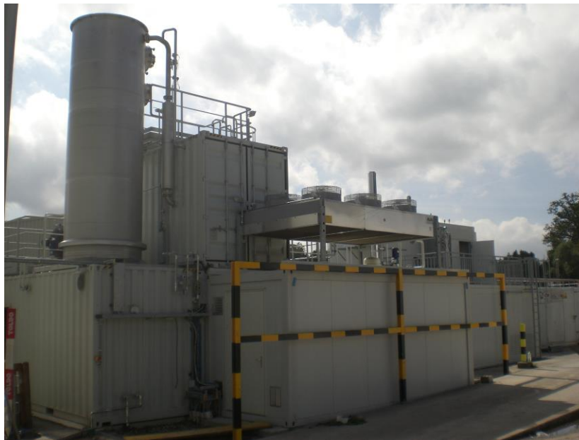
Abfallanlage Kompogas Biogasaufbereitung Volketswil CH 250 Nm 3 /h Biogas Baujahr 2010
