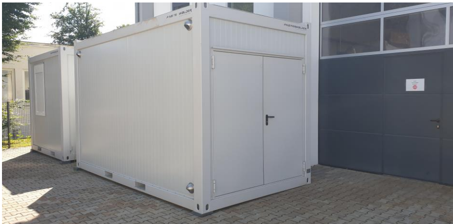
Biogasaufbereitung 10 bar Entfernung H 2 S und Trocknung für probioLNG-Verfahren Uni Hohenheim
