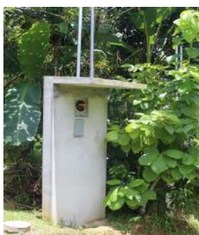
Ilustración 5-30 Estructura sin uso para conexión de luz en Tres Hermanas
