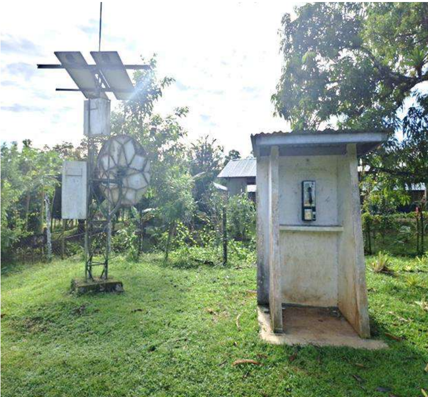
Ilustración 5-31 Cabina Telefónica ubicada en Coquillo de Uracillo
