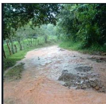
Vías en mal estado
