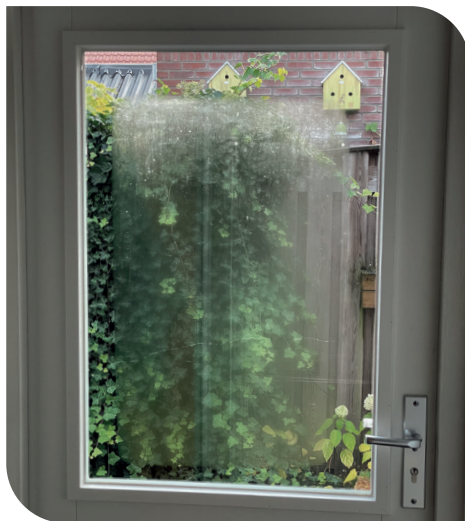
Condensvorming aan de kamerzijde.
