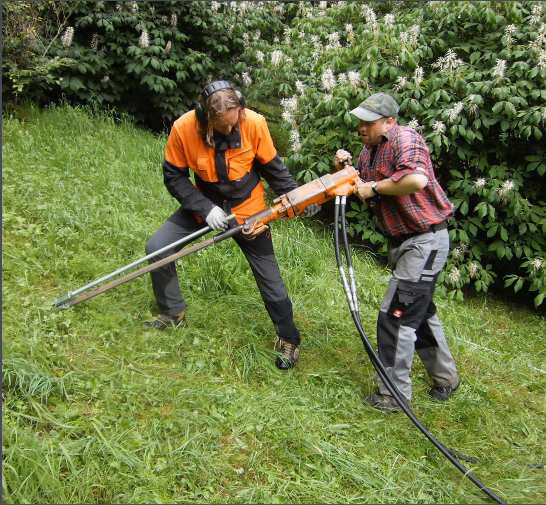
↑ Erdverankerung einer prägenden Rotbuche mit Riesenporlingsbefall im Wurzelbereich | Quelle: Stadt Überlingen Abt. GUF
