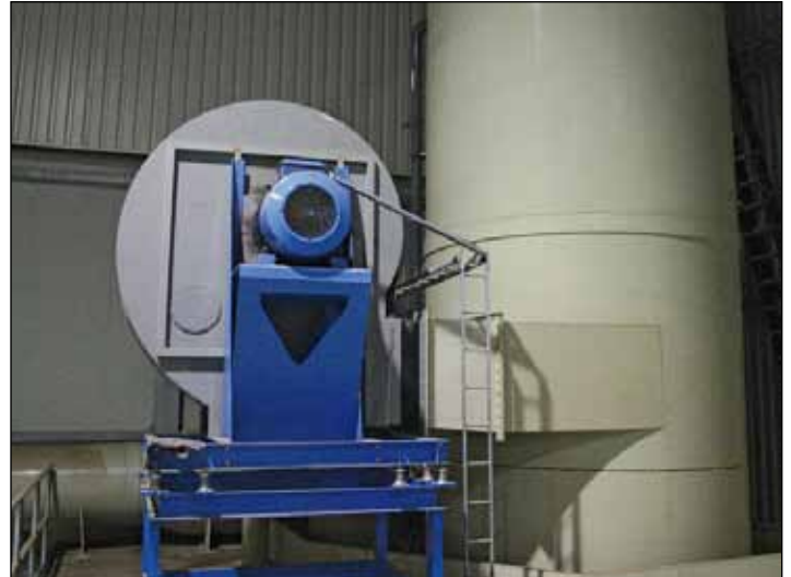
2 Filteranlage einer eingebauten Säurewirtschaft
