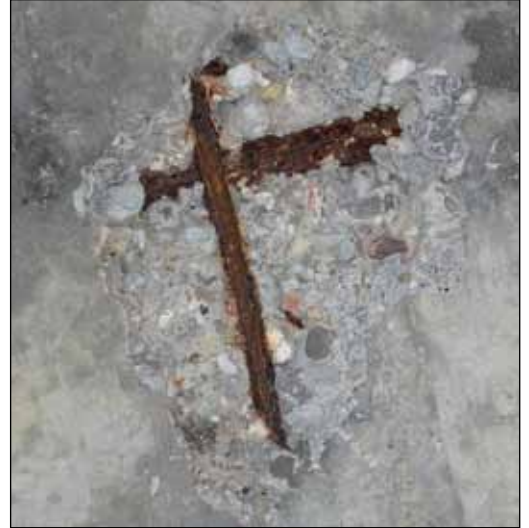
2 Durch Feuerverzinken vermeidbar: Betonkorrosion
