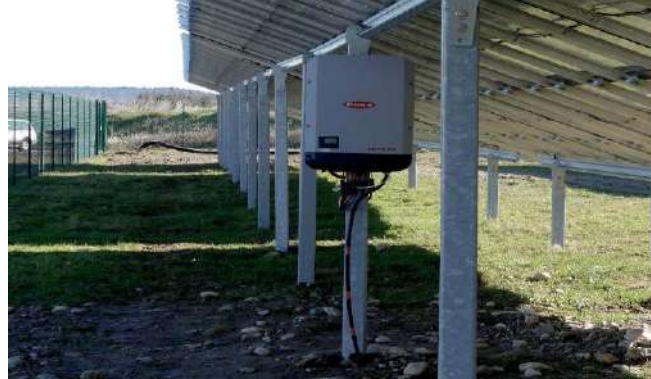
Onduleurs (localisés sous les structures porteuses)
