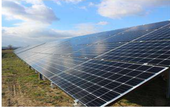
Structures et panneaux solaires
