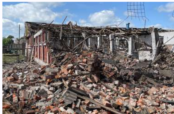
Дитячо-юнацька кінно-спортивна школа, зруйнована РФ під фундамент в м. Дергачі, Харківська обл., 30 травня, 2024. (Суспільне Харків)
