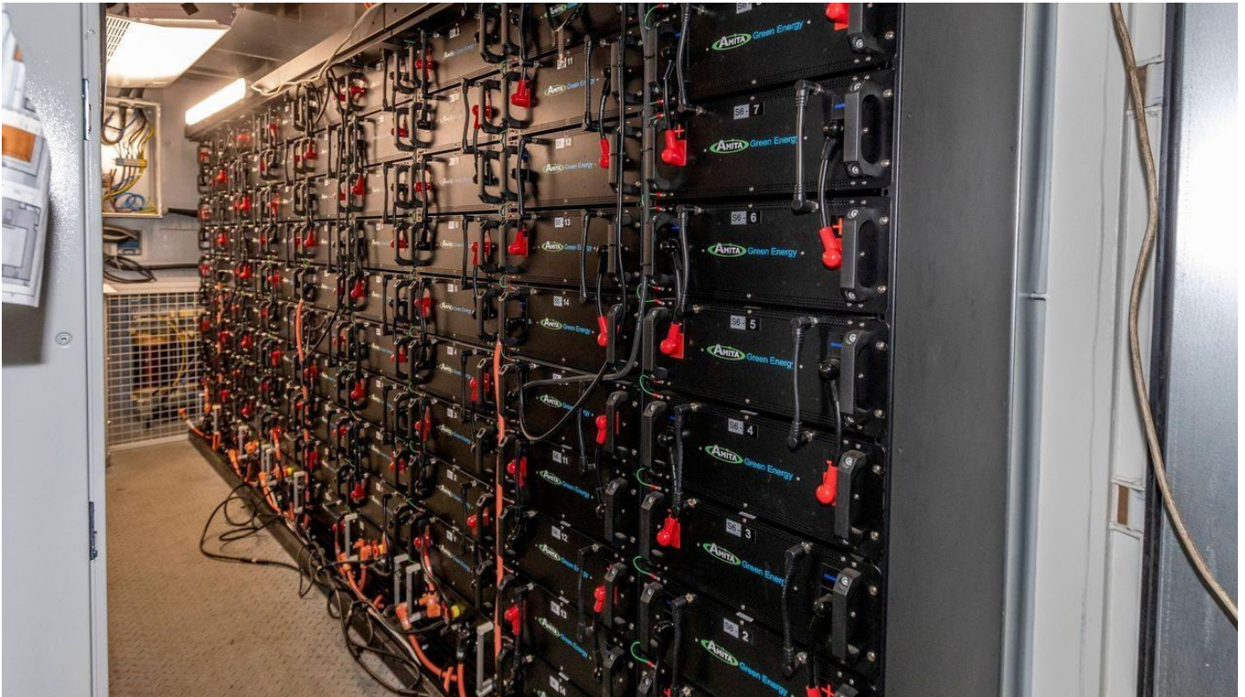
Figur 5: EST-Floattechs 390 kWh containerisert løsning for bygg- og anleggsplasser. Kilde: KlimaOslo 22 .
