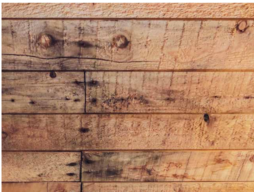
Tydligt fuktpåverkad råspont.
