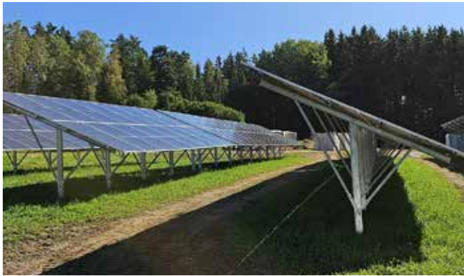
AgriPV UNO Modulvorderkante bis 2,10 Meter
