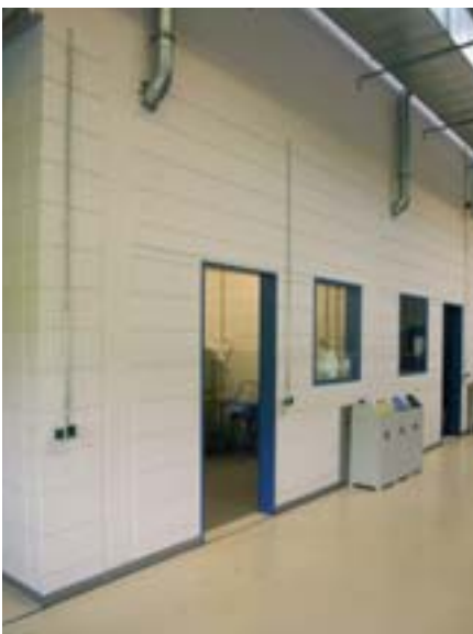
Installationen sind sichtbar und frei zugänglich.
