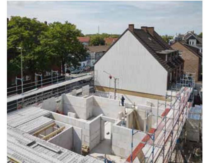
KS-Kreislaufsteine wurden bei der Errichtung eines viergeschossigen Wohnungsbaus in Hamm eingesetzt. © Olaf Mahlstedt / KS-ORIGINAL
