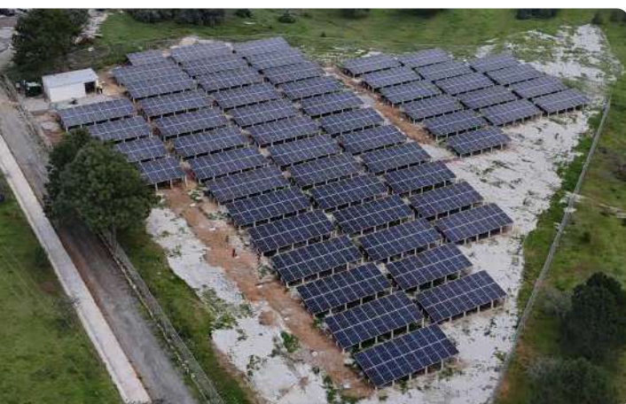
Minas de Zacatlán Industria minera | Solar | Potencia instalada: 499 kWp | Modalidad: Groundmounted
