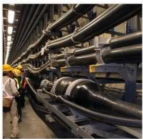
地下輸電線路
