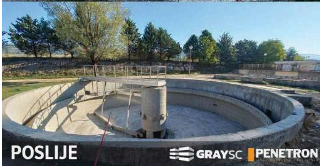
Postrojenje za prečišćavanje otpadnih voda, Grude Izvođač: Regeneracija d.o.o.
