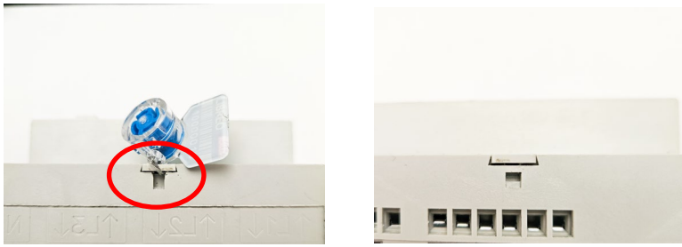
Abbildung 21 beschädigter Steg – rechts intakter Steg am Zählergehäuse
