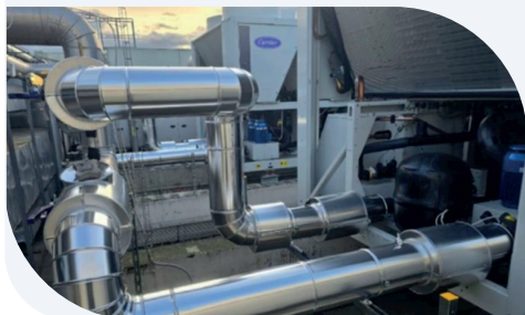
POMPES À CHALEUR
