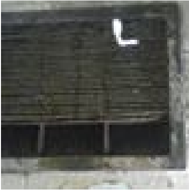
10e Air vents unsafe
