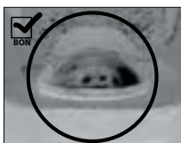
TIGE OVALE DU BOULON ASSISE ADÉQUATEMENT
