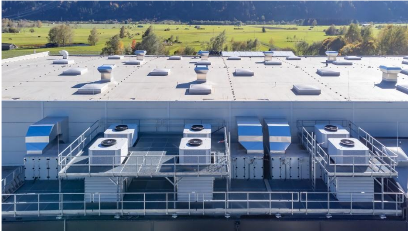
Bild 01: Die erbaute SHC-Anlage sorgt für konstant temperierte und saubere Hallenluft.
